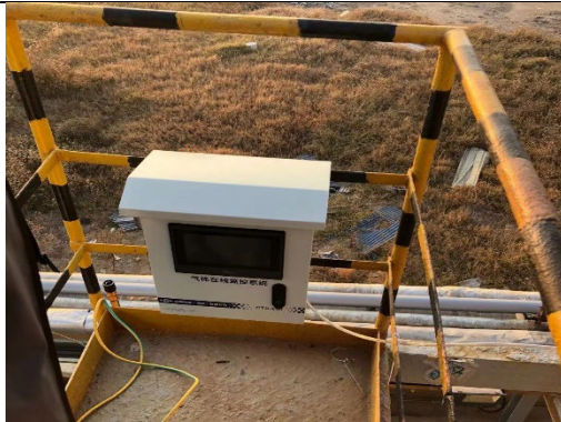
氯化氢三级降膜水吸收排气筒在线监测
