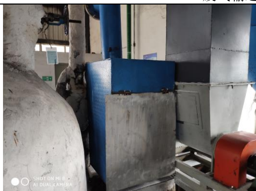
投料环节废气收集装置
