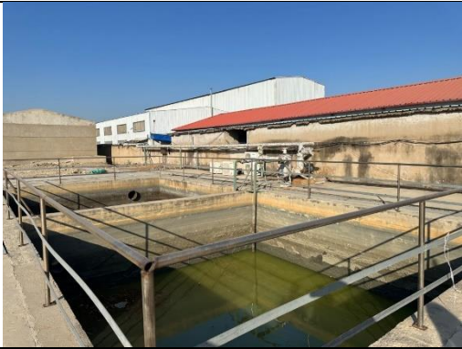
厂区北部废水收集池及架空输送管线
