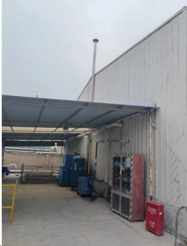
排气筒（百菌清悬浮剂）
