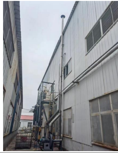
排气筒（可湿性粉剂）
