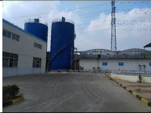
厂区污水处理站
