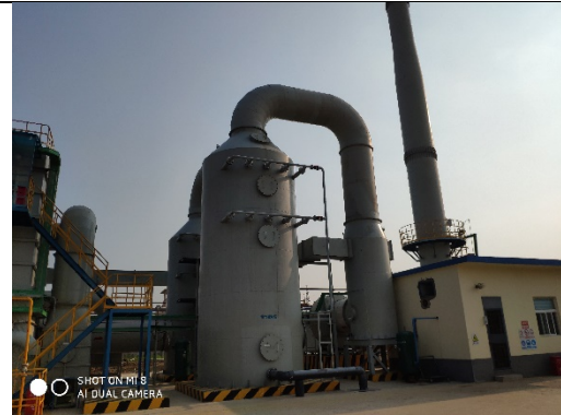
现有 RTO 装置尾气喷淋塔及排气筒
