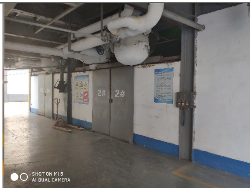
氯氰基苯装置密闭出料柜
