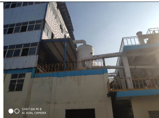
氯氰基苯装置密闭出料柜配套吸收塔
